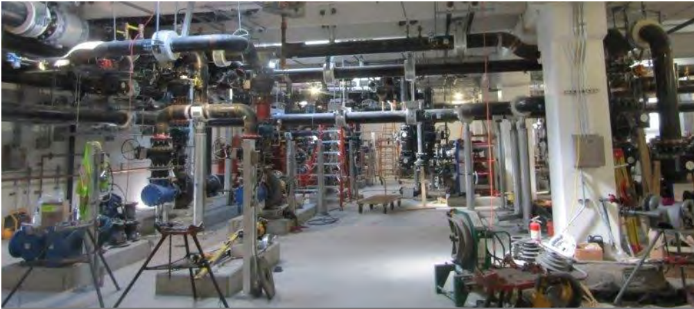
PAR 1395 – Metro Biogas – Boiler Process Piping
