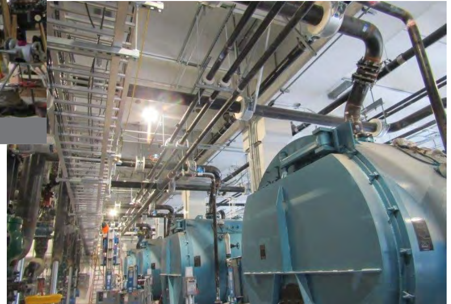
PAR 1395 – Metro Biogas - Boilers
